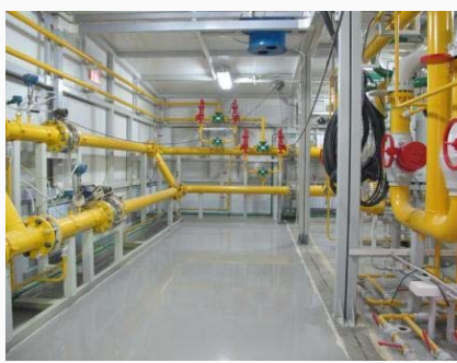
Автоматизированные газораспределительные станции (АГРС) моноблочного исполнения
