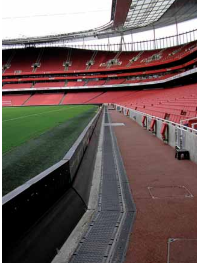
Сервисные каналы на стадионе Arsenal
